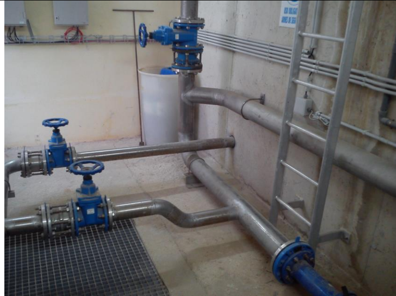
Cámara de llaves del depósito de agua potable de Caparroso
